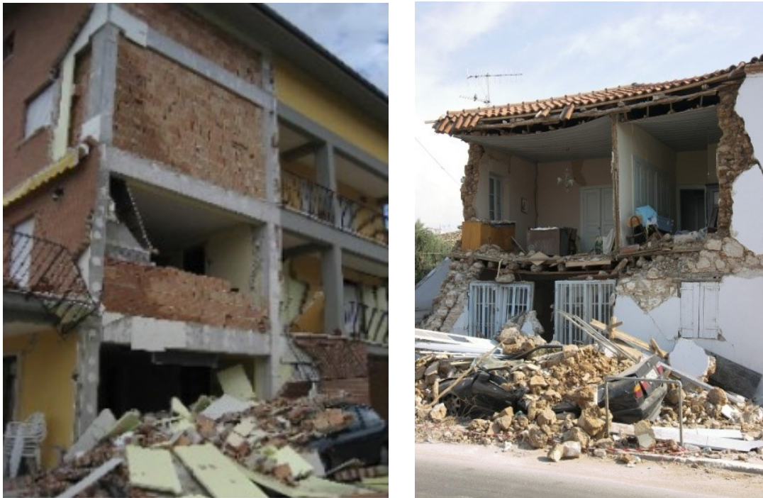
Εικόνα 153: Κτίρια μετά από σεισμό
