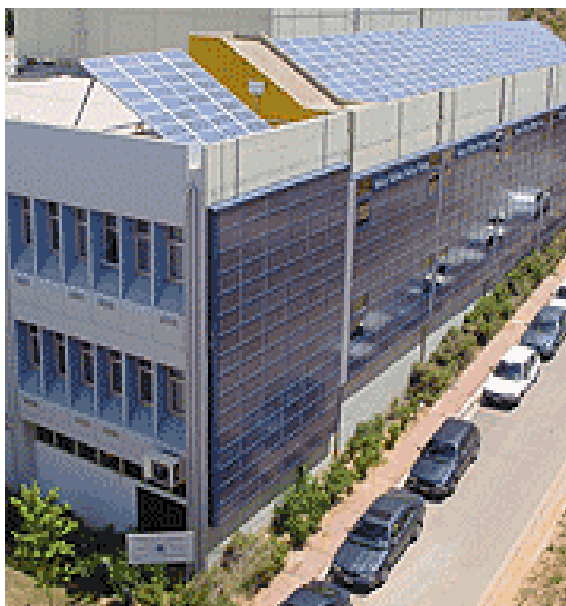
Εικόνα 151: Φωτοβολταϊκό σύστημα στην όψη της σχολής Χημικών Μηχανικών ΕΜΠ
