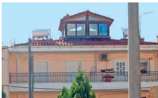
Εικόνα 118. Αυθαίρετη κατασκευή σε κτίριο κατοικίας
