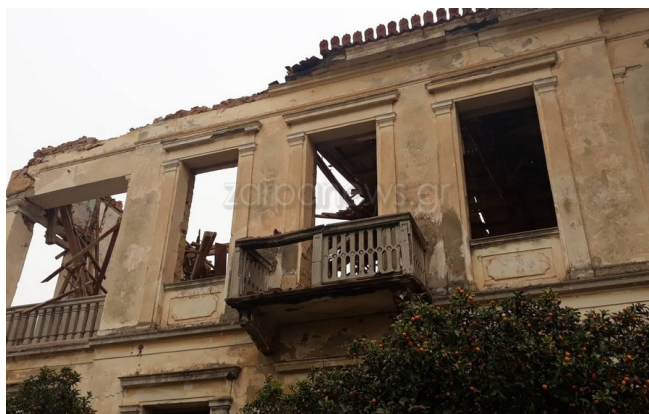
Εικόνα 89. Ανακατασκευή ακινήτων και στοιχείων Αρχιτεκτονικής Κληρονομιάς, υπό κατεδάφιση ή σε επικίνδυνη ετοιμορροπία
