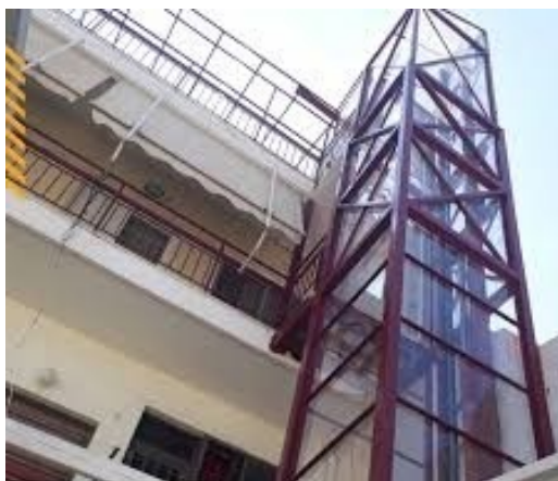
Εικόνα 79. Αναβατόριο/ανελκυστήρας σε αδόμητο χώρο οικοπέδου με υφιστάμενο κτίριο
